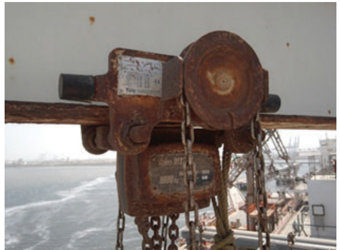
Korrodiertes Yalelift Flaschenzug mit integriertem Fahrwerk - nach 9 Jahren im Einsatz weiterhin funktionsfähig
